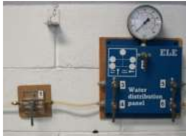
Panel de control de válvulas
